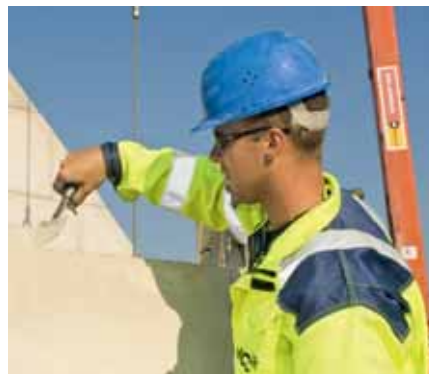
Sorgfalt und Genauigkeit sind gefragt: Ein Mitarbeiter auf einer Baustelle von NCC beim Mauern. Foto: NCC Deutschland GmbH
